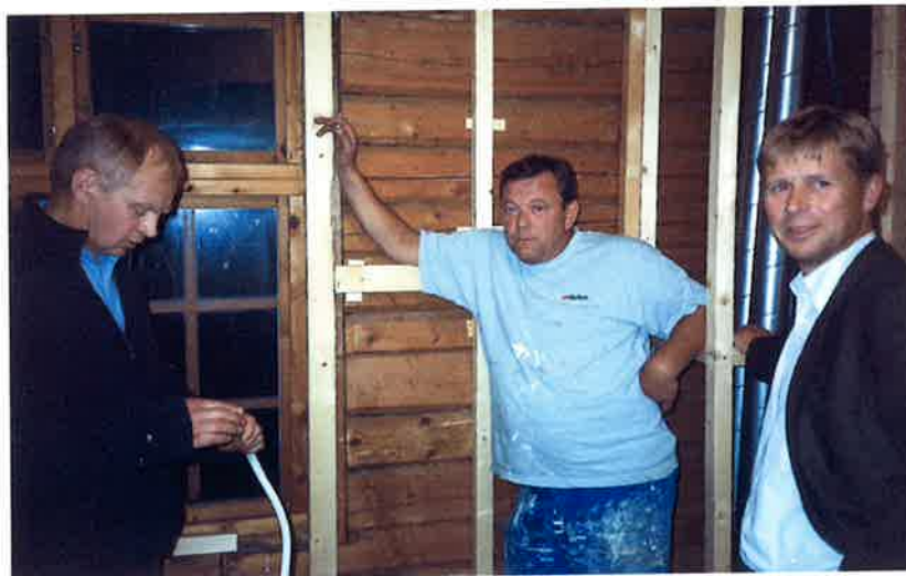
Widar arbeider med fornying av veggene og får tekniske råd av Christian og Petter Otto.
